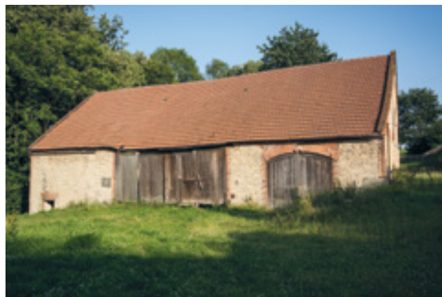
16. Severní fasáda samostatně stojící stodoly, 2015, foto V. Říhová. Northern facade of a detached barn. Nordfassade der alleinstehenden Scheune.
