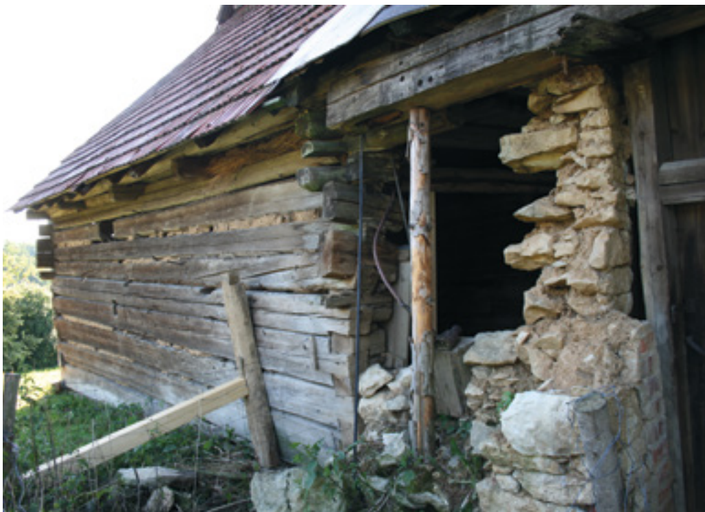
17. Severní část severozápadního průčelí, stěna podstáje a devastovaný přístavek studničního stavení, 2015, foto V. Říhová. Northern part of the north-west facade, sub-stable wall and a devastated annexe of the well house. Nördlicher Teil der nordwestlichen Fassade, Wand des Schuppens und zerstörter Anbau des Brunnenhauses.
