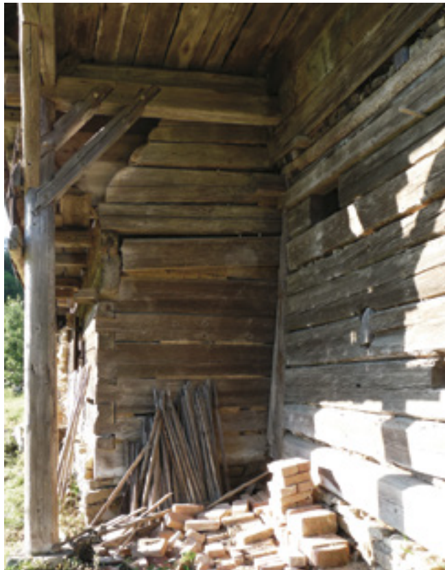
18. Severovýchodní trakt, severní nároží roubeného domu s fragmentem staršího štítu, 2015, foto Z. Křenková. North-east wing, the northern corner of the timbered house with a fragment of an earlier gable. Nordöstlicher Trakt, nördliche Ecke des Blockhauses mit dem Fragment des älteren Giebels.
