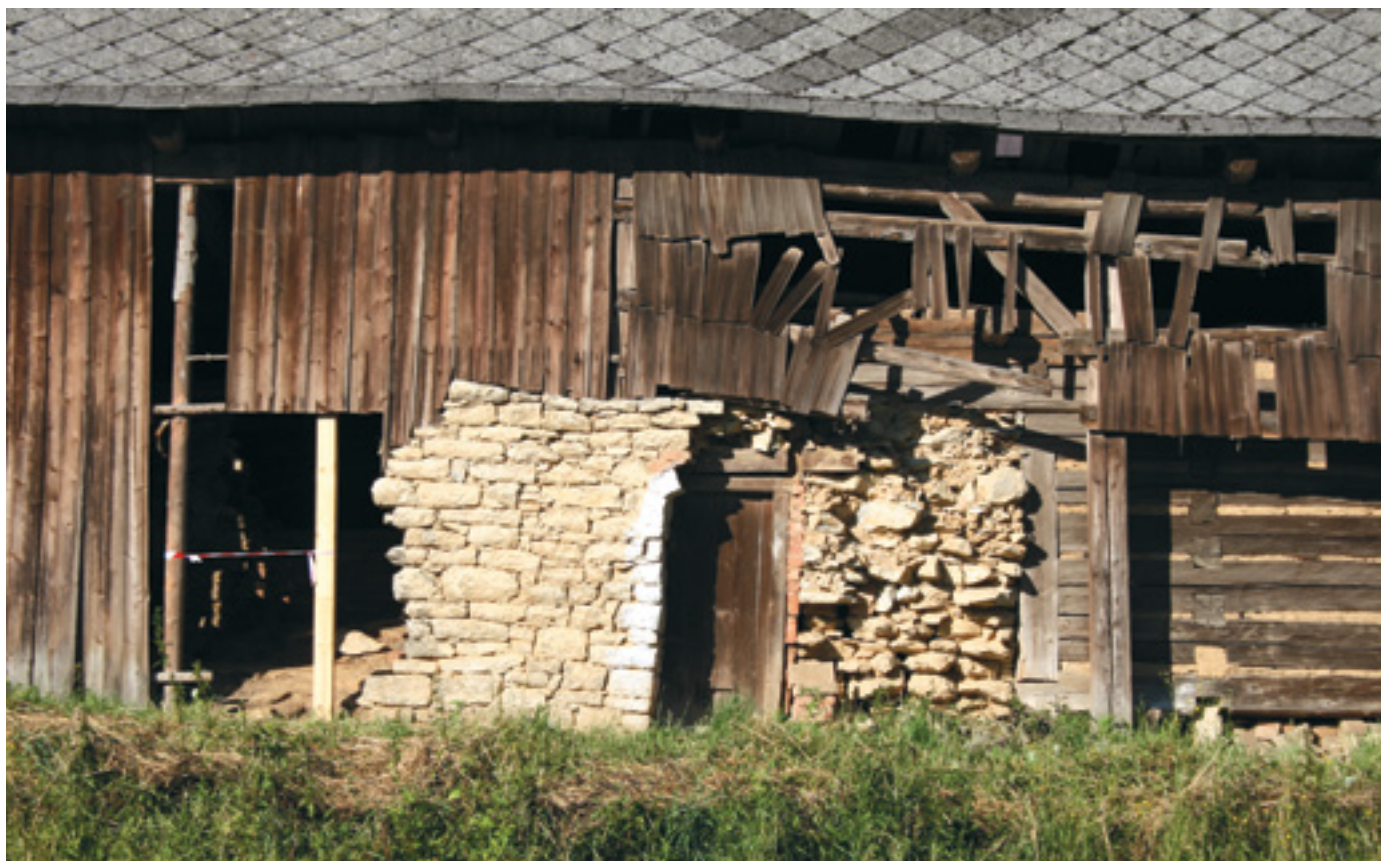
20. Střední partie severovýchodního průčelí rouběného domu s destruovaným obvodovým zdivem síně a černé kuchyně, 2015, foto V. Říhová. Central part of the north-east facade of the timbered house with destroyed perimeter masonry of the hall and smoke kitchen. Mittelteil der nordöstlichen Fassade des Blockhauses mit zerstörten Umfassungsmauern des Flurs und der Rauchküche.
